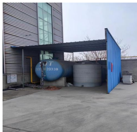
龙昌公司一体化水处理设施
