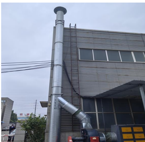
15m 高排气筒
