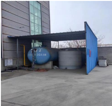
一体化污水处理设施
