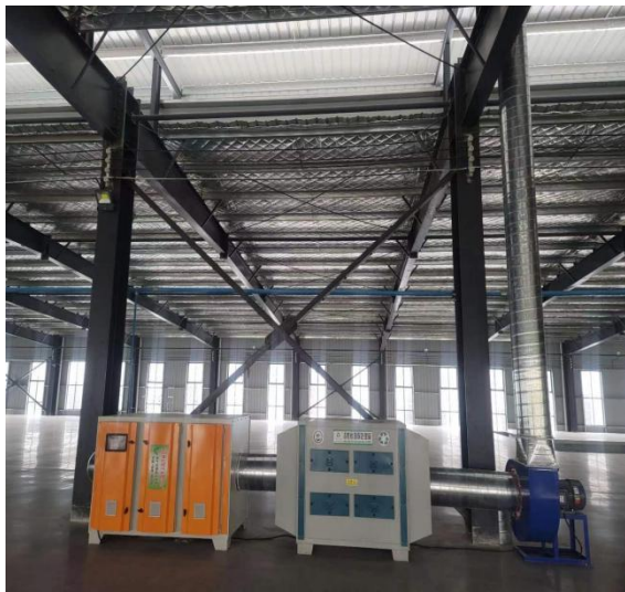
UV 光氧+活性炭吸附+15m 高排气筒
